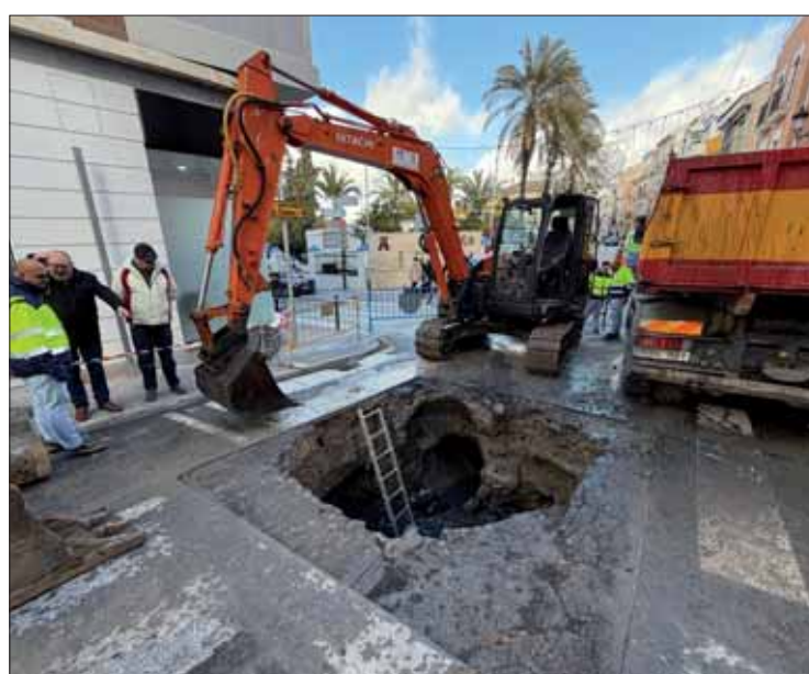
La actuación se situó en la confluencia de la calle Juan Carlos I con Del Agua/FP
