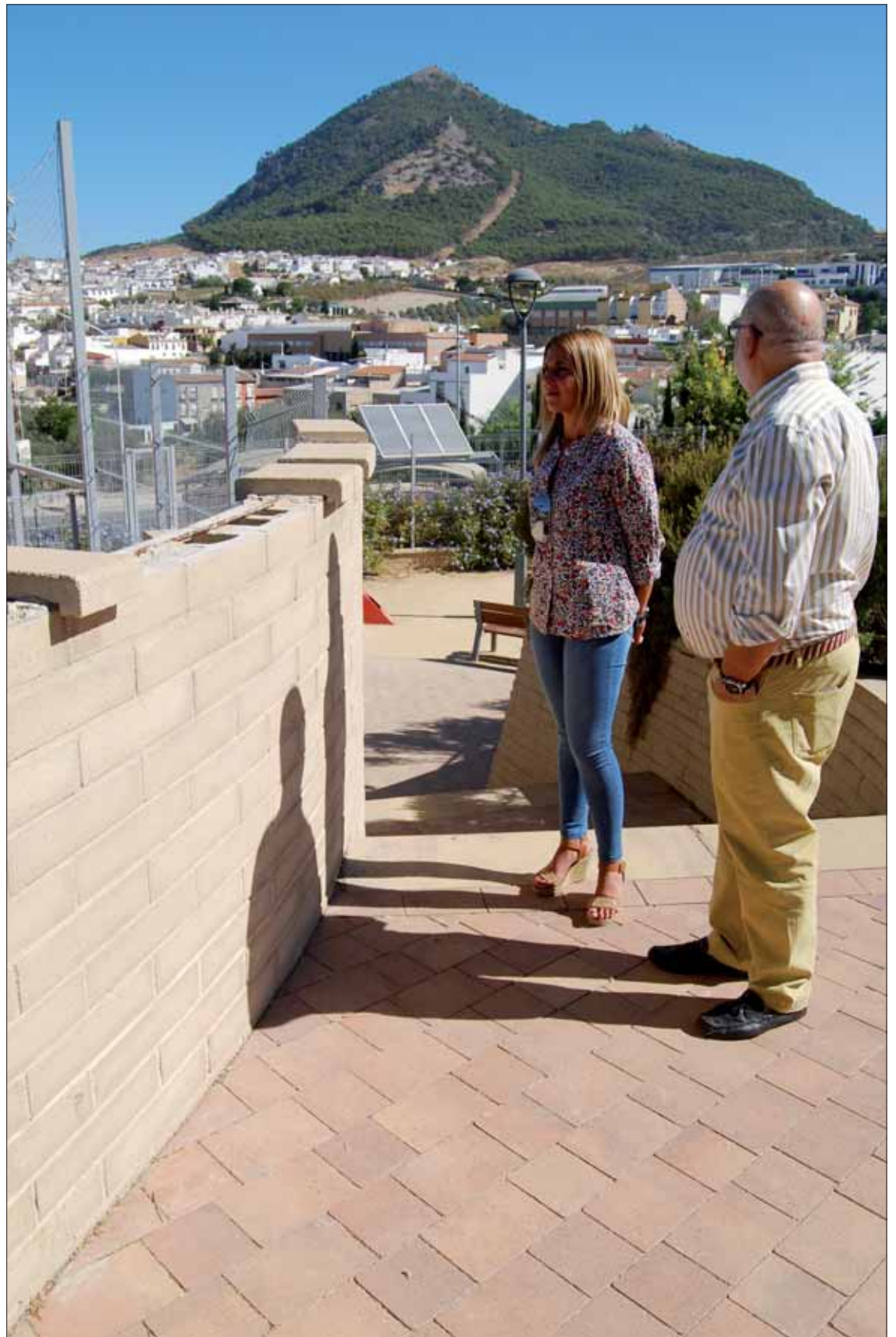
Entre los desperfectos provocados, destaca la rotura en obra civil como las terminaciones de los muros/FP
