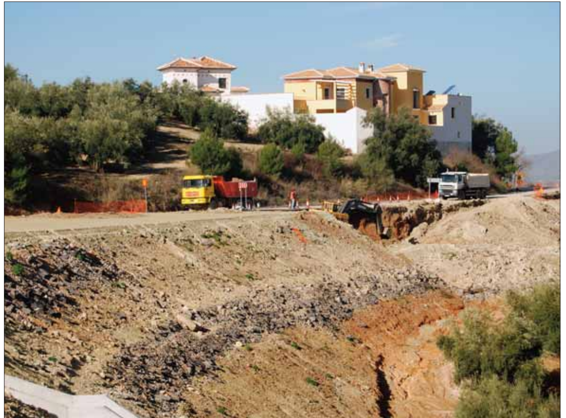
Se licitan las obras de la carretera Rute a Encinas Reales, paradas desde 2008/ARCHIVO
