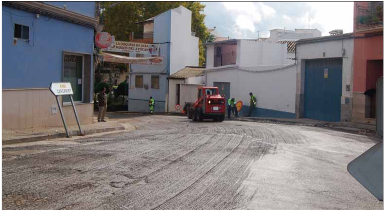
Las máquinas han levantado el firme deteriorado para colocar la nueva capa de asfalto/F. Aroca
