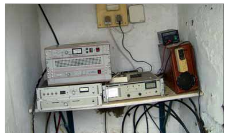
Estado actual de los equipos de alta frecuencia/AL
