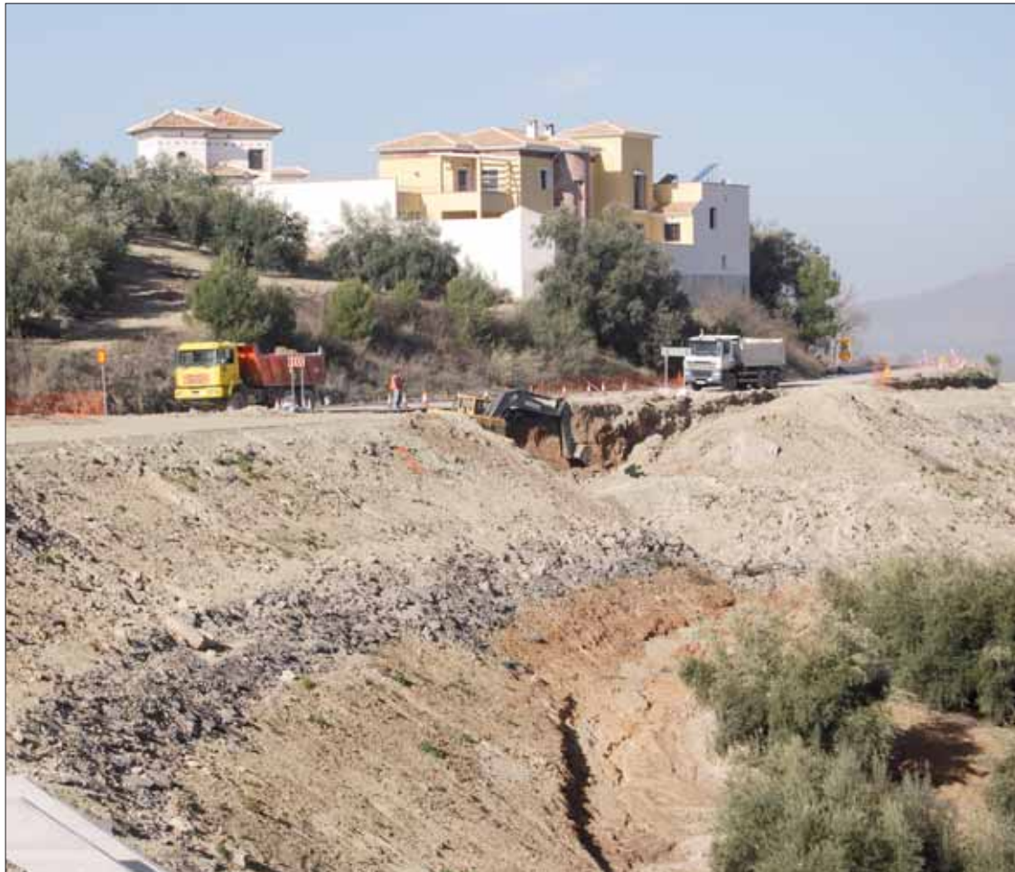
Puente que se ha derrumbado y que ha obligado a cerrar de nuevo el tramo/MM
