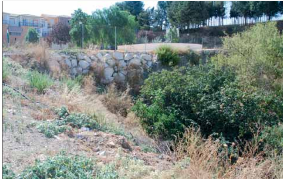
La parte que aún no ha sido entubada está prácticamente cubierta por la maleza/FP
